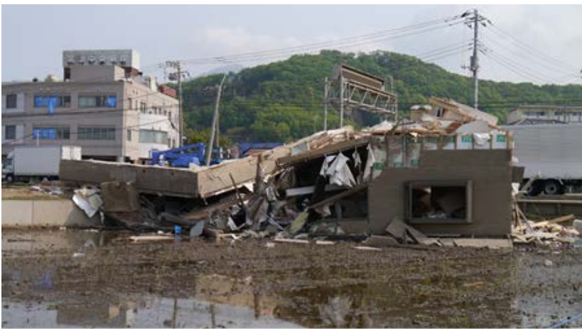
べた基礎ごと転倒した住宅
